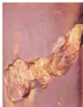
Коррозийная трещина на стенке нагревательного котла
